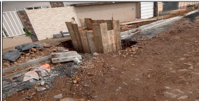
16 | Rua Afonso Pena - drenagem pluvial - boca de lobo
