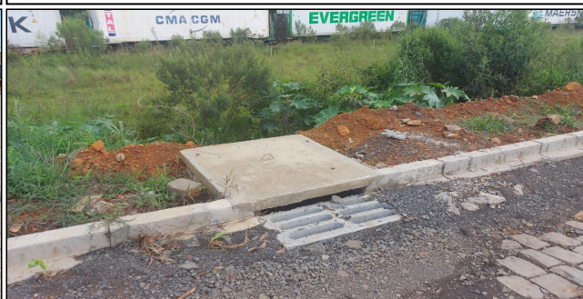
8 | Rua Cel. Tiburcio Cavalcante - boca de lobos
