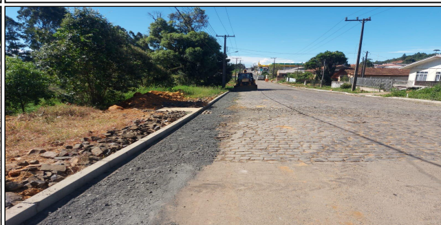
10 | Rua Cel. Tiburcio Cavalcante - boca de lobos
