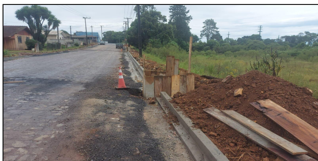
5 | Rua Cel. Tiburcio Cavalcante - boca de lobos
