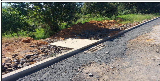
9 | Rua Cel. Tiburcio Cavalcante - boca de lobos
