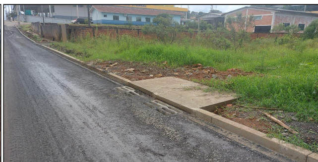
6 | Rua Cel. Tiburcio Cavalcante - boca de lobos
