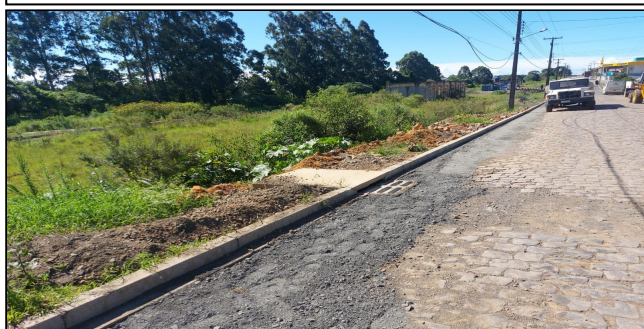
7 | Rua Cel. Tiburcio Cavalcante - boca de lobos
