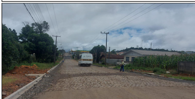
11 | Rua Cel. Tiburcio Cavalcante - boca de lobos
