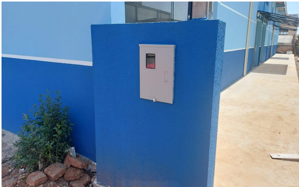
Imagem 03 – Entrada de energia
