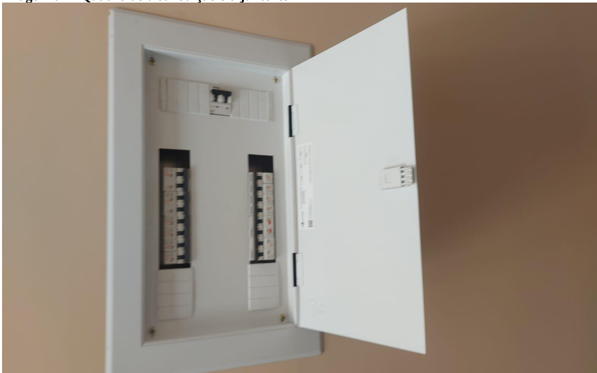
Imagem 07 – Quadro de distribuição e disjuntores
