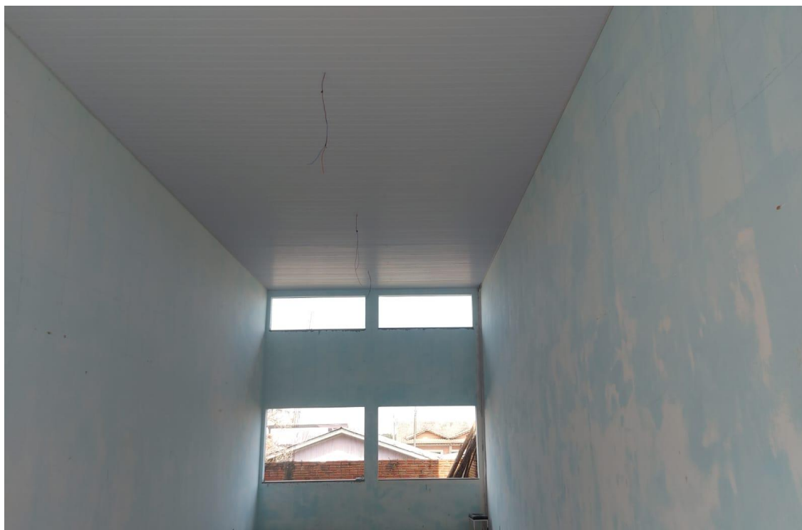
Imagem 07 – Forro em PVC
